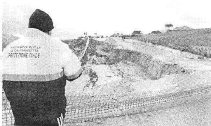
Una strada franata nel nisseno
